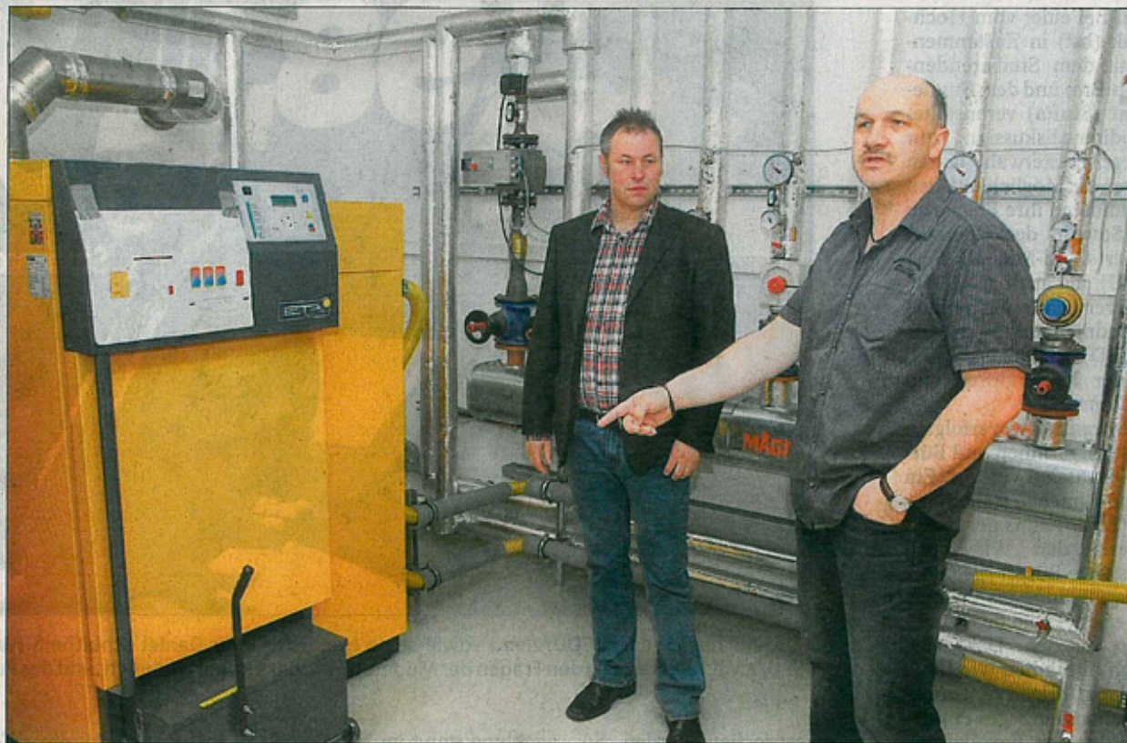
Im Gegensatz zu alten Zeiten zeigt sich der Heizungsraum im Bürgerhaus heute wie eine gute Stube. Bürgermeister Peter Grimm (re.) und sein Stellvertreter Lothar Schubert, nehmen die Heizung in Augenschein. Foto Karl-Heinz Veit
